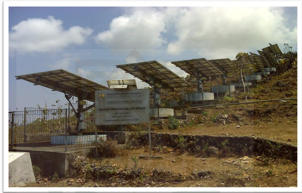
Gambar 2 : Tampak dari bawah Pembangkit Air Tenaga Surya (PATS)
