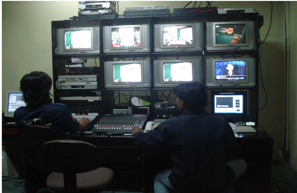
Control room, nampak dari kiri master control sedang memilih gambar dengan menggunakan mixer visual, Sementara di sebelahnya, terlihat operator telepon membantu mengoperasikan mixer audio
