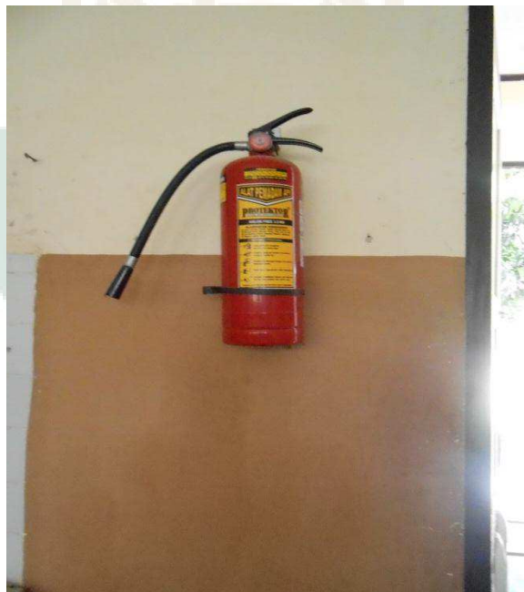
Gambar 6. Tabung pemadam kebakaran
