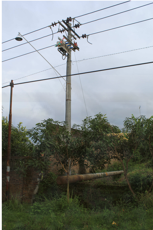
1.3 jaringan listrik baru 3 phasa sudah terpasang di Perumahan Domas Salatiga
