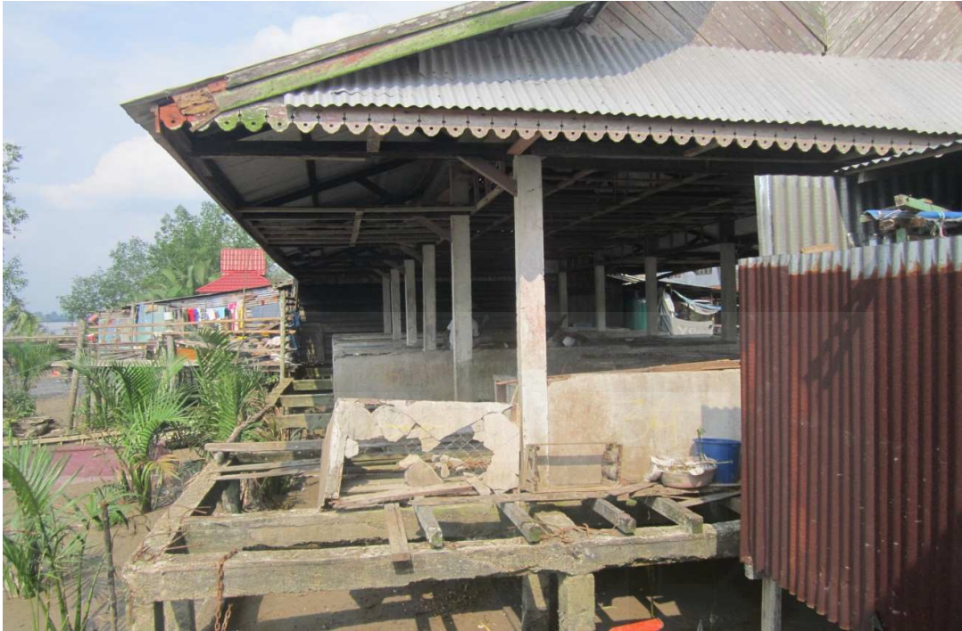
Gambar 15 : Kondisi TPI yang tidak terurus lagi
