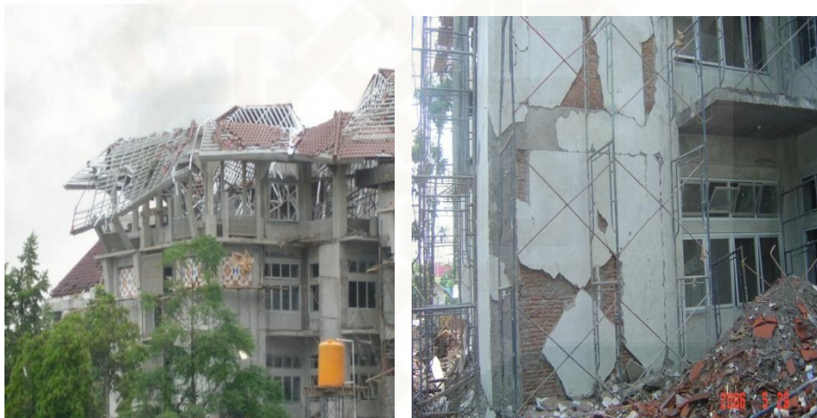
Gambar 1.2. Gedung Fakultas Ushuludin akibat gempa 2006
