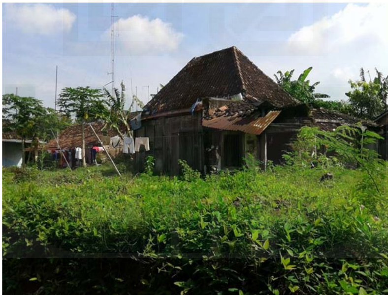
Rumah milik Abdul Kahar Muzakkir di Kotagede. Foto tahun 2015. Hanya menyisakan bangunan tengah, bangunan luarnya telah hancur akibat gempa bumi 2006 dan kini ditumbuhi semak belukar.
