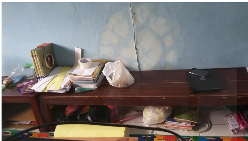
Lampiran 15: Cat tembok berwarna biru yang sudah mulai pudar
