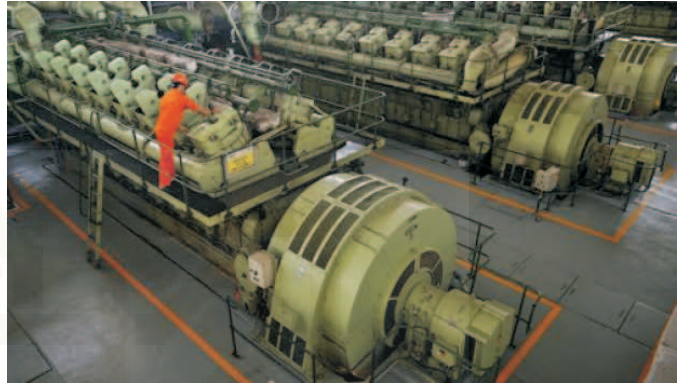
Gambar 2.13 Generator pada PLTD. Sumber: bioenergi.com
