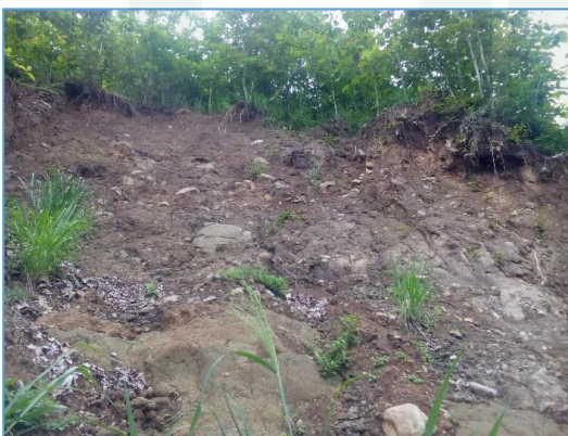
Gambar 5. Bekas Longsor ( Februari 2015)
