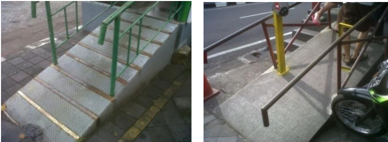
Gambar 2 Kondisi ramp yang masih curam sumber: survey lapangan 2013
