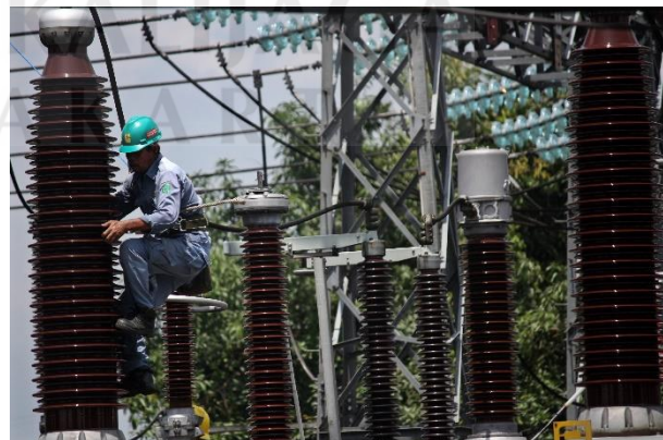
Gambar 2.1 Instalasi Pembangkit Listrik Nasional (PLN)
