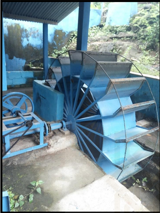
Gambar 3.6 Turbin yang dihubungkan pada Rotor Sumber: Dokumentasi Pribadi
