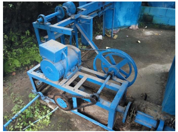
Gambar 2.10 Generator PLTMH Singosaren Sumber: Dokumentasi Pribadi
