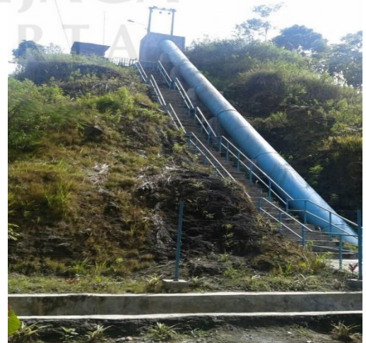
Gambar 2.8 Pipa Penstock PLTMH Cilongok Sumber: Dokumentasi Pribadi
