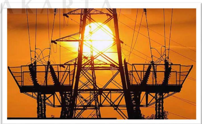
Gambar Instalasi Pembangkit Listrik Sumber : uk.pinterest.com
