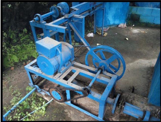
Gambar 3.2 Generator PLTMH Singosaren Sumber: Dokumentasi Pribadi
