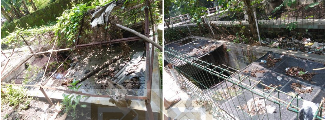
Gambar 4 dan 5: Bak Penampungan IPAL Komunal 1, 2 dan 3
