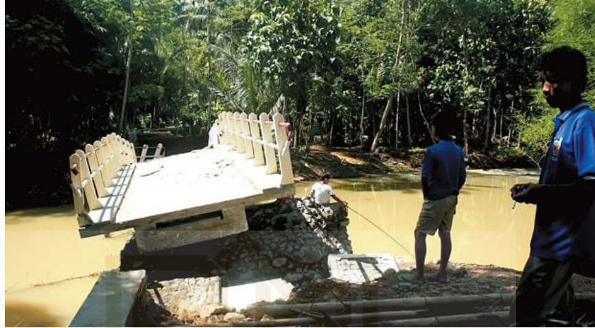
Gambar 1.2 Jembatan Kadigunung ambrol diterjang banjir (Sindonews, 2015).
