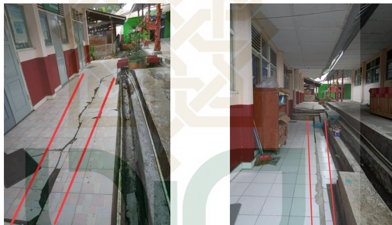
Gambar 1.1 Retakan bangunan SMPN 1 Samigaluh akibat gerakan tanah
