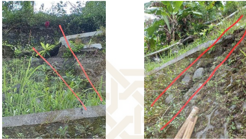
Gambar 1.2 Retakan pondasi akibat gerakan tanah
