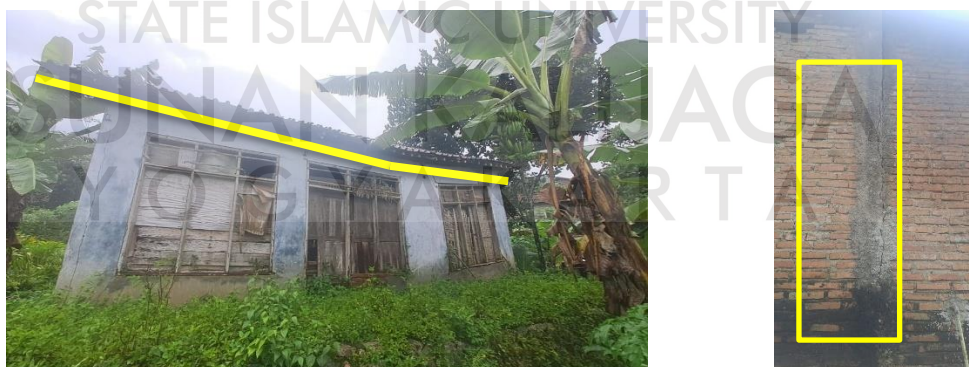
Gambar 1.2 Kerusakan bangunan pada kawasan permukiman sebagai indikasi adanya aktivitas gerakan tanah
