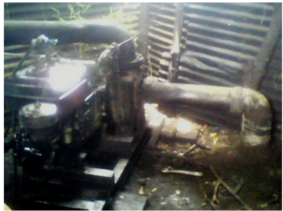
Mesien Diesel Pada Stasiun Pompa
