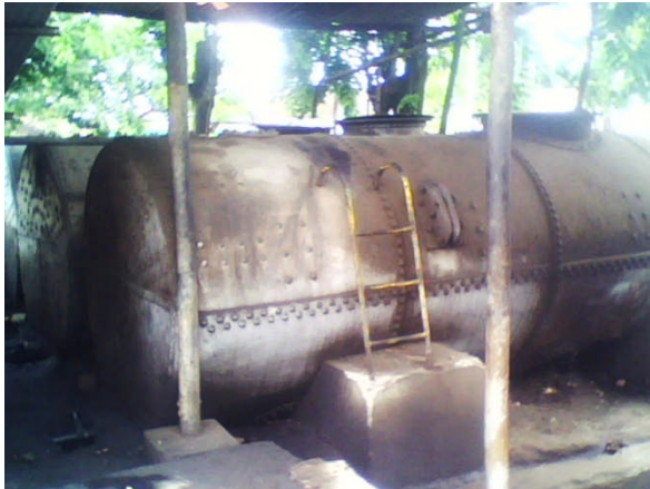
Tangki Penampungan Solar
